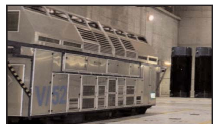
Abb. 2: Behälter für abgebrannte Brennelemente nach der Ankunft im Zwischenlager
